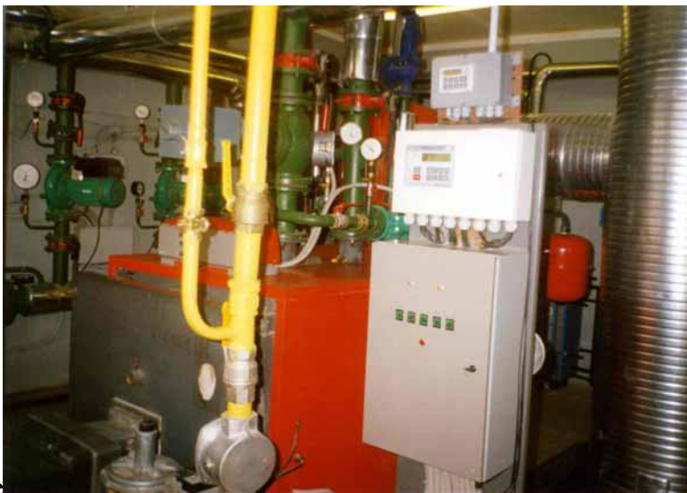
Рисунок 2. СПЕКОН СКЗ-13 обеспечивает автоматизированное управление квартальной котельной в г. Курске.
