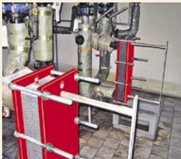
Часть ИТП дома
